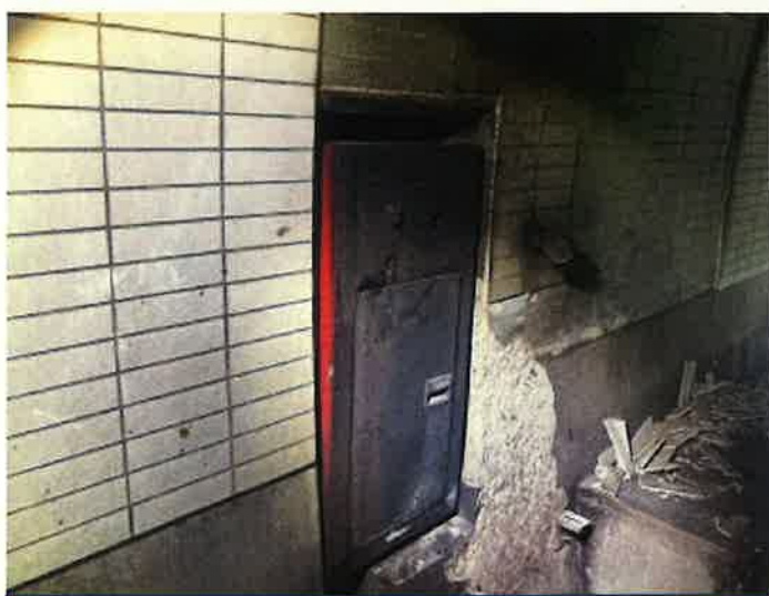
九州自動車（熊本）でのトンネル車両火災
