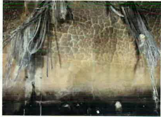
コンクリート表面の亀甲状のひび割れ
