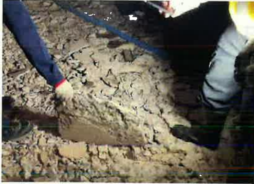
剥離したコンクリートが路面に落下
